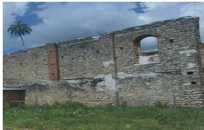
Figura 4 – Alterações na fachada lateral com fechamento dos vãos das janelas do segundo pavimento e introdução de um pilar de tijolos.
